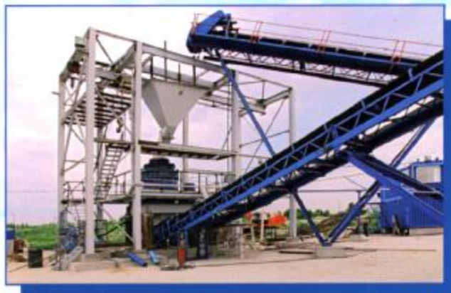
«ТСМ-Н», г. Санкт-Петербург. Установка на базе дробилки КИД-1200М
